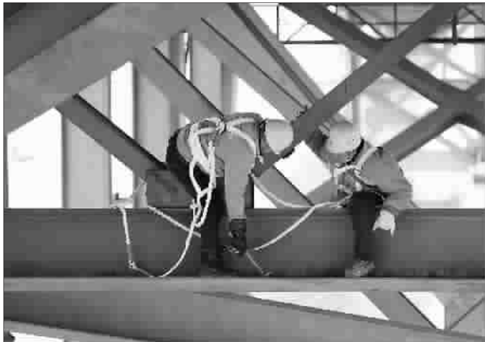
春运期间,每天都有130余趟列车通过九江长江大桥,平均15分钟左右就有一趟。为了保障列车安全畅通,大桥检修工人们始终坚守在自己的岗位上,默默守护着大桥与旅客的安全。图为昨日在九江长江大桥铁路桥下,检修工人在检查螺栓和钢梁状况。
